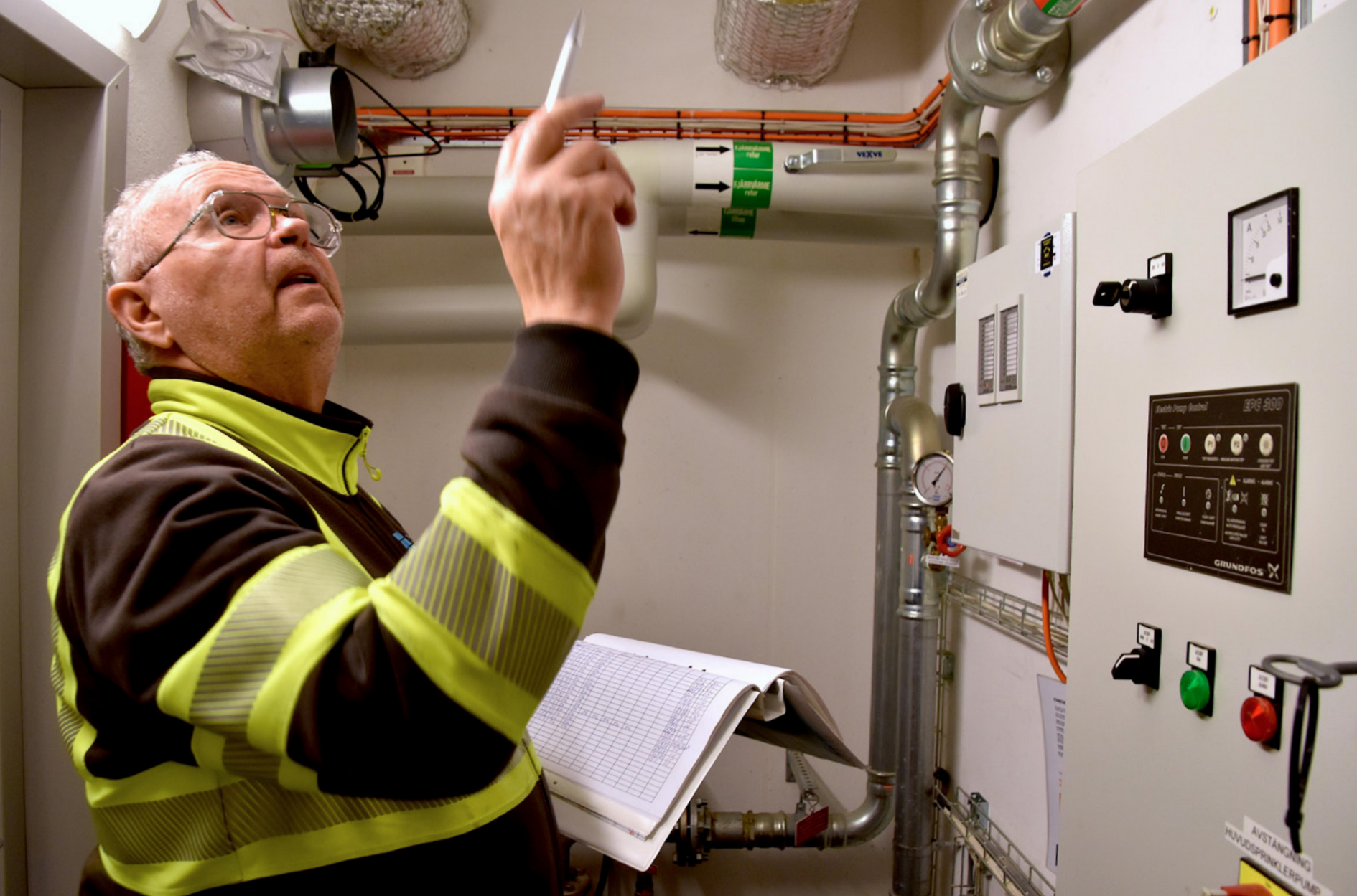
Den veckovisa kontrollen av sprinklersystemet på Villa Joneberg visar att det funkar precis som det ska.
